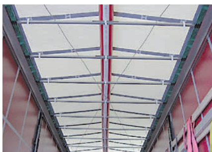
Der aufgeblasene Luftschlauch sorgt dafür, dass sich auf dem Dach kein Wasser bilden kann.
